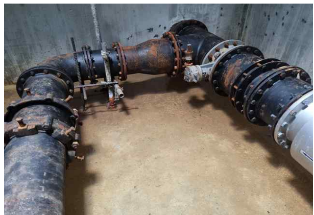
손상내용 유량계실 받침콘크리트 미설치 손상원인 시공미흡
