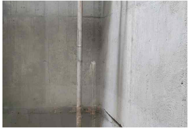
손상내용 통합유출밸브실 우벽 백태 손상원인 외부 우수유입
