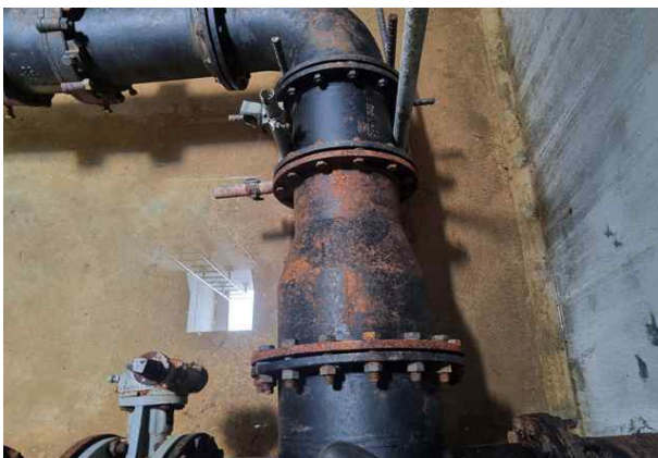
손상내용 유량계실 관부식 손상원인 습윤침투
