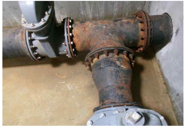
손상내용 유량계실 관부식 손상원인 습윤침투
