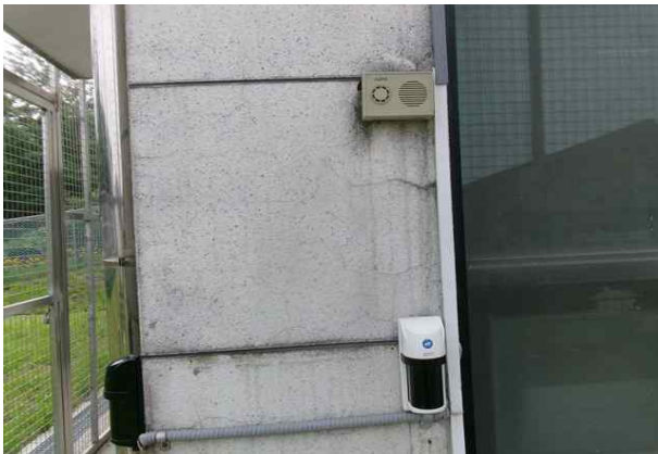
손상내용 검수실 외부 벽체 균열 손상원인 건조수축, 온도변화
