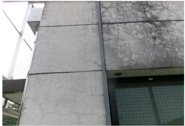
손상내용 검수실 외부 벽체 균열 손상원인 건조수축, 온도변화
