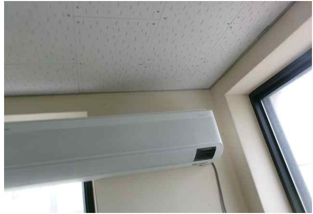
손상내용 제어실 내부 벽체 균열 손상원인 건조수축, 온도변화
