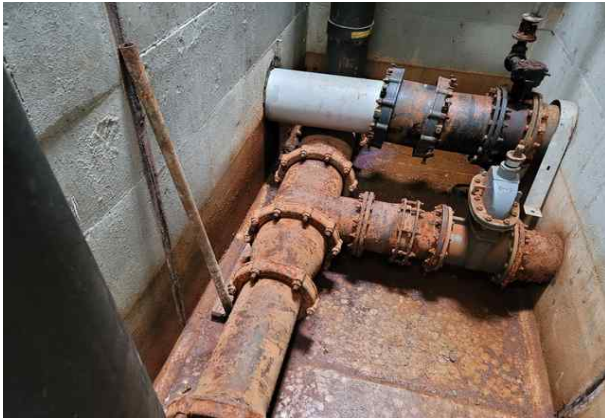
손상내용 통합유출밸브실 우벽 관부식 손상원인 습윤침투
