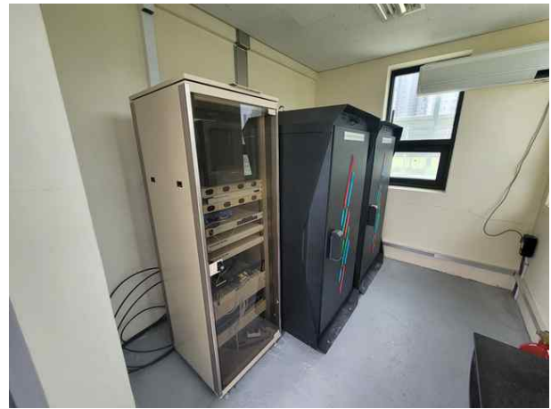
제어실 내부 전경
