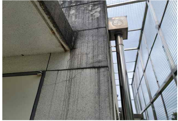
손상내용 검수실 외부 벽체 망상균열 손상원인 건조수축, 온도변화
