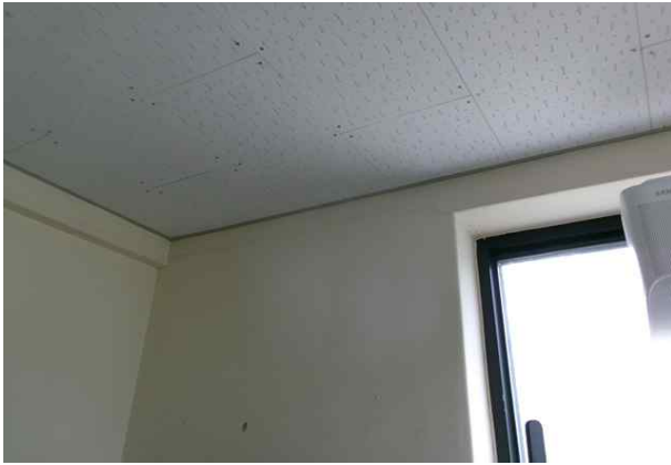
손상내용 제어실 내부 벽체 균열 손상원인 건조수축, 온도변화
