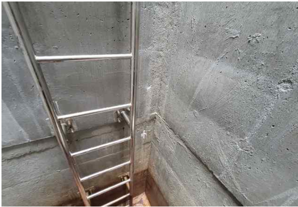
손상내용 통합유출밸브실 좌벽 백태 손상원인 외부 우수유입
